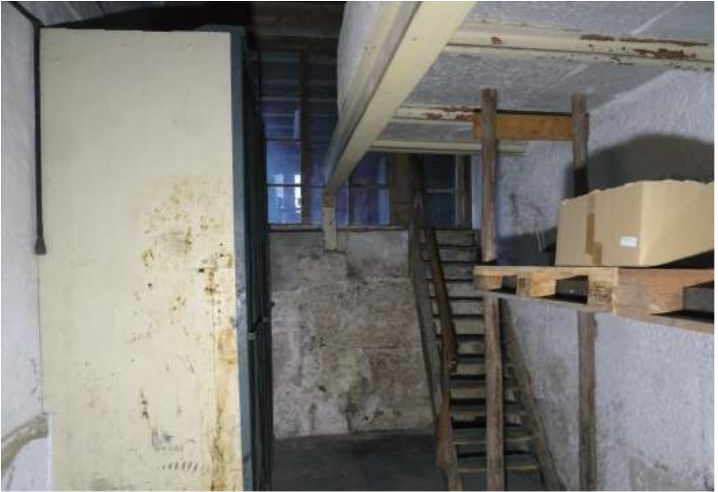
Der Anbau mit nachträglicher Wand (rechts) und Podest (oben) aus Stahlträgern und Sandsteinplatten
